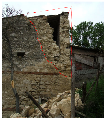
Fig. 2 – Collasso di un cantonale in un edificio in muratura di pietrame colpito dal recente sisma in Abruzzo (2009)
